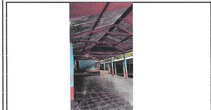
Foto1: ESCENARIO Y AULA, Sustitución de estructura portante galvanizada y sustitucion de lamina por lamina troquelada aluzinc calibre 26
